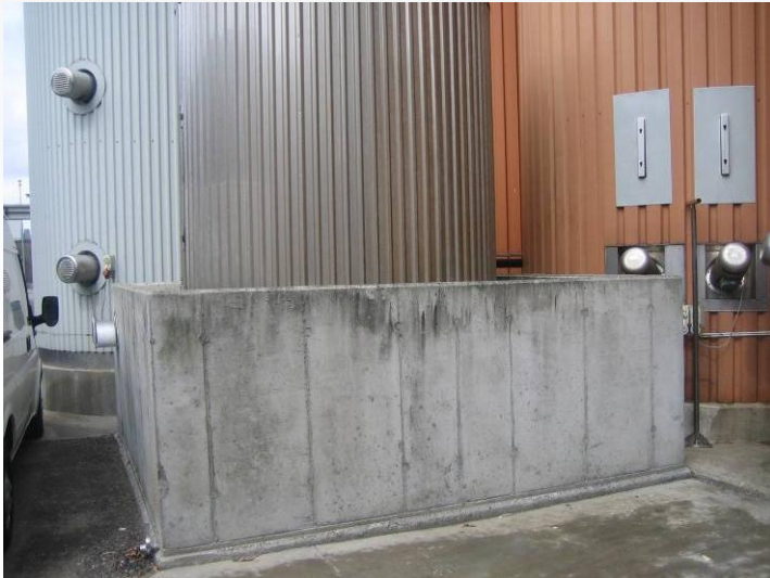
Mur som afgrænser kemikalietank - ingen påkørsel og effektiv opsamling
