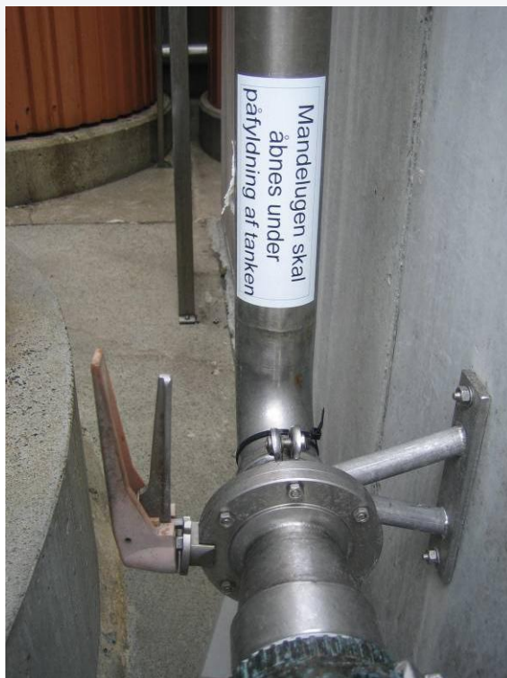
Opmærkning af rørsystemer
