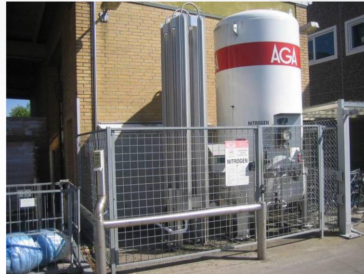
Sikring mod påkørsel og uvedkommende adgang forbudt
