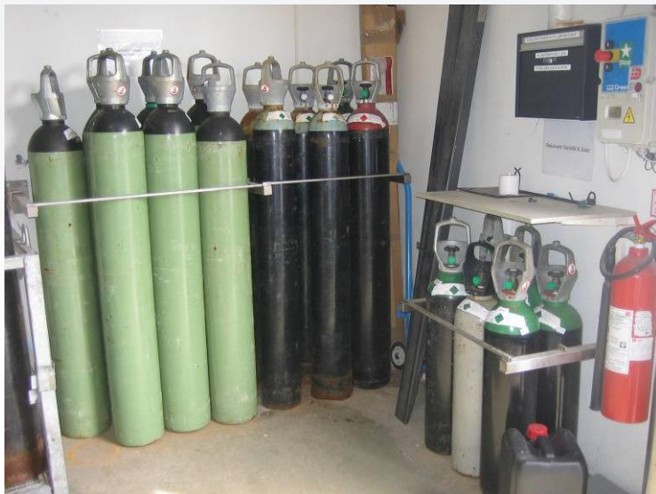
Opbevaring af gasflasker - sikring mod væltning og væk fra færdselsveje
